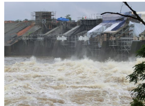
Rehabilitering av de 10 flomlukene fra 1964 på inntaksdammen til Mt. Coffee kraftverket. FOTO: Knut Gakkestad
