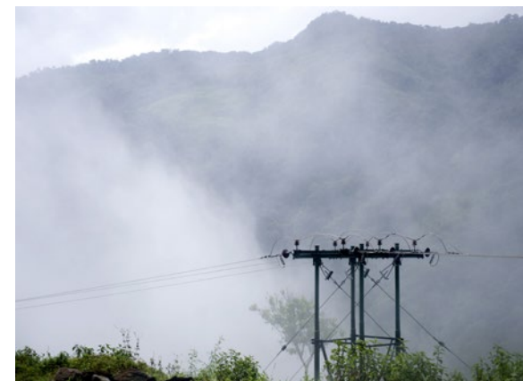
Kraftledning i fjellskapet ved Tala-dammen, Bhutan. FOTO: Ken Opprann
